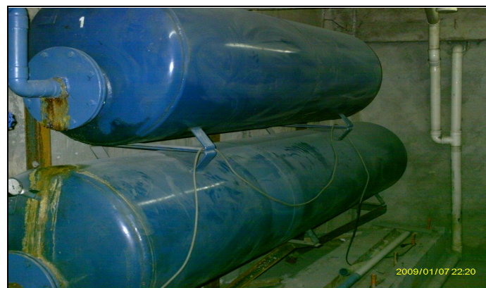
ESTANQUES DEL HIDROPACK
