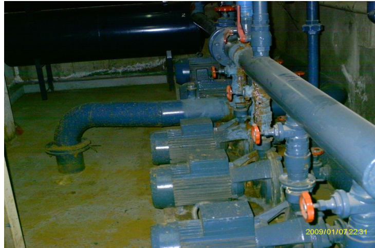
BOMBAS, MANIFOLDS Y ESTANQUES
