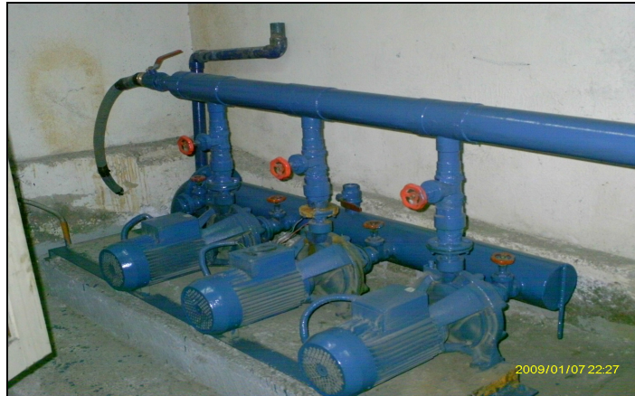
BOMBAS Y MANIFOLD
