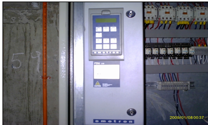
PANEL DE CONTROL CON VARIADOR DE VELOCIDAD
