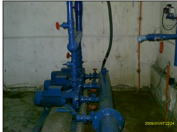
BOMBAS Y MANIFOLD
