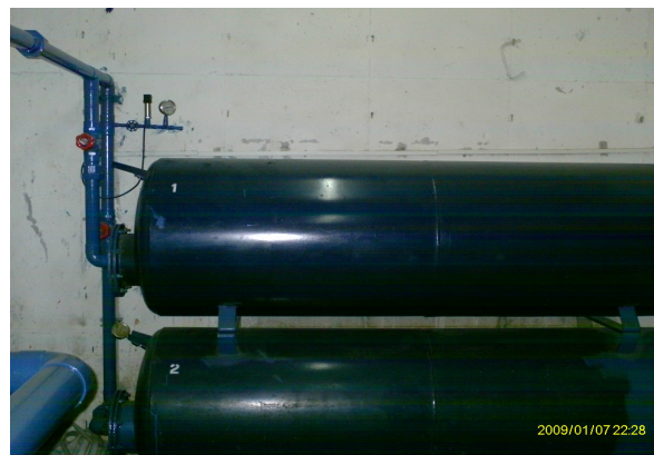
ESTANQUES DEL HIDROPACK
