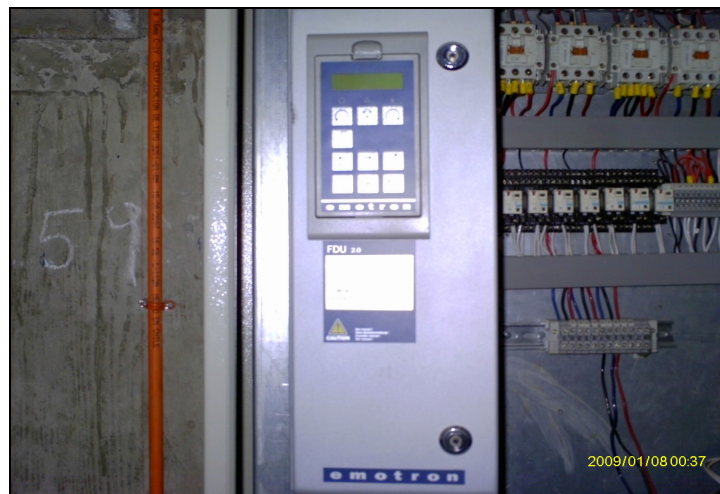
PANEL DE CONTROL CON VARIADOR DE VELOCIDAD
