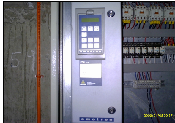
PANEL DE CONTROL CON VARIADOR DE VELOCIDAD
