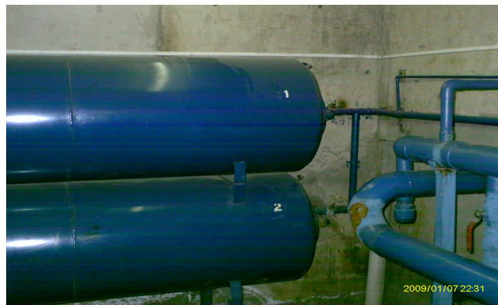
ESTANQUES DEL HIDROPACK
