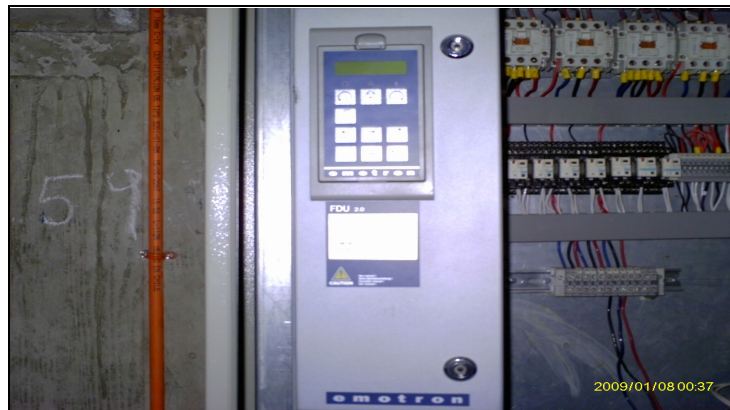
PANEL DE CONTROL CON VARIADOR DE VELOCIDAD
