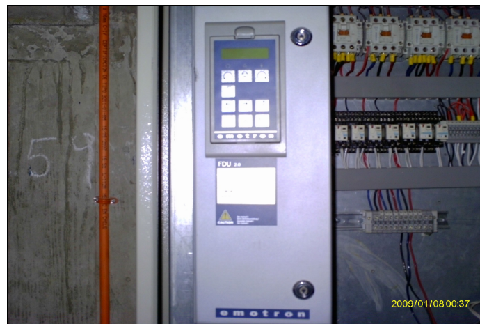
PANEL DE CONTROL CON VARIADOR DE VELOCIDAD
