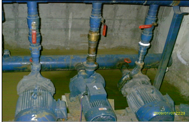
BOMBAS Y MANIFOLD
