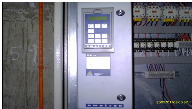
PANEL DE CONTROL CON VARIADOR DE VELOCIDAD
