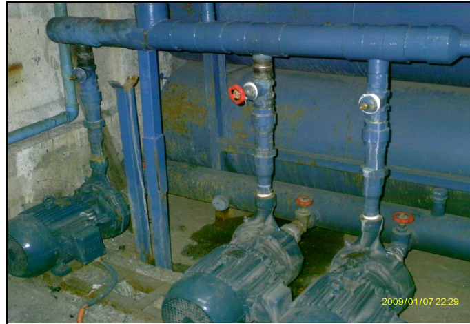
BOMBAS Y MANIFOLD
