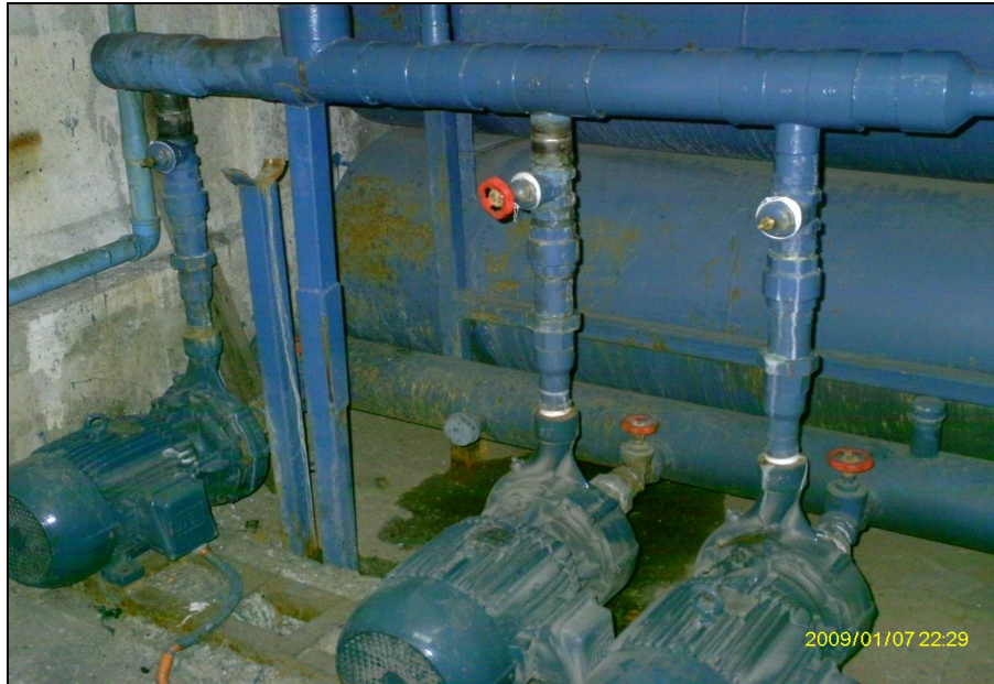
BOMBAS Y MANIFOLD
