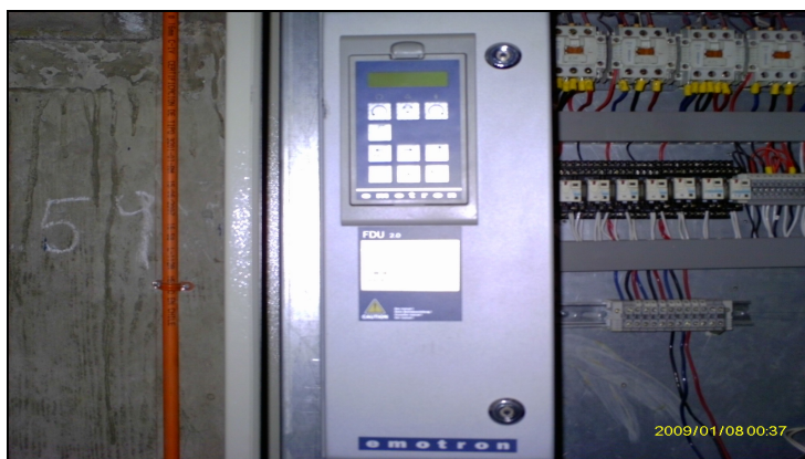
PANEL DE CONTROL CON VARIADOR DE VELOCIDAD
