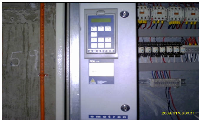
PANEL DE CONTROL CON VARIADOR DE VELOCIDAD
