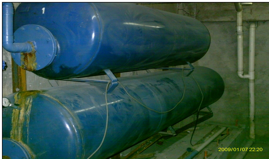
ESTANQUES DEL HIDROPACK
