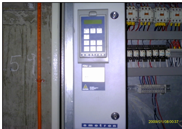
PANEL DE CONTROL CON VARIADOR DE VELOCIDAD
