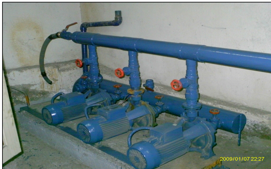
BOMBAS Y MANIFOLD
