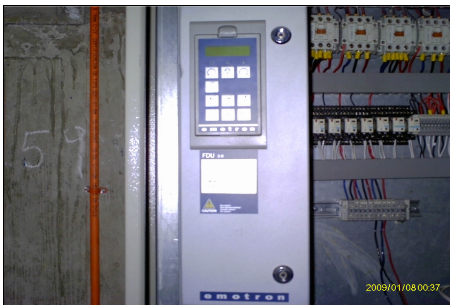
PANEL DE CONTROL CON VARIADOR DE VELOCIDAD
