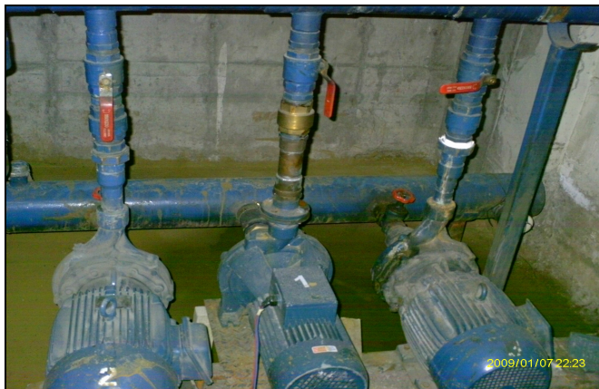
BOMBAS Y MANIFOLD
