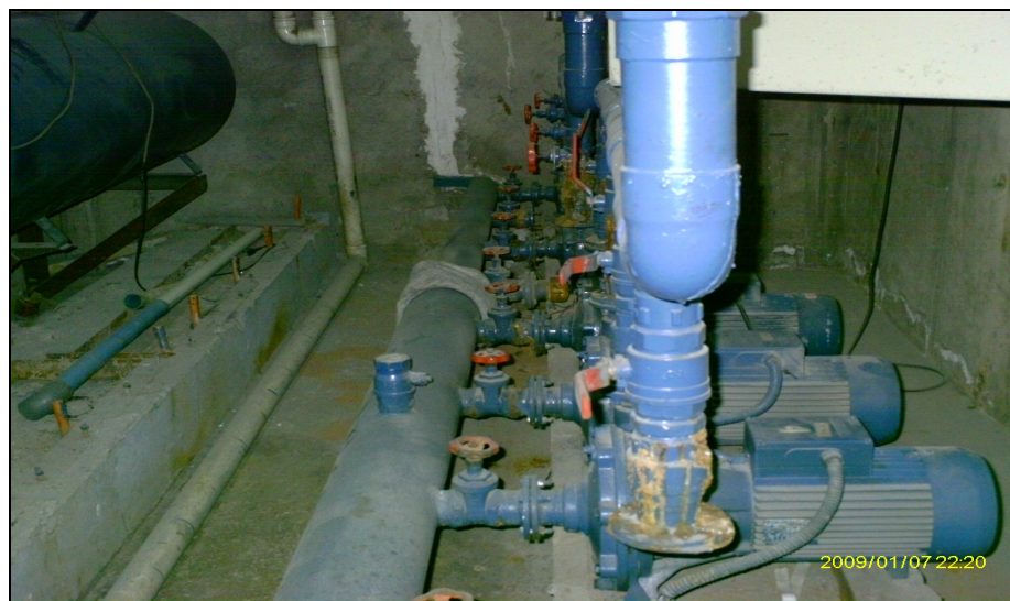
BOMBAS Y MANIFOLD DEL CIRCUITO DE BAJA
