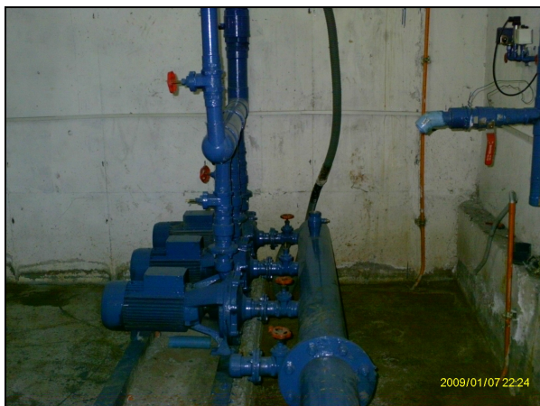
BOMBAS Y MANIFOLD
