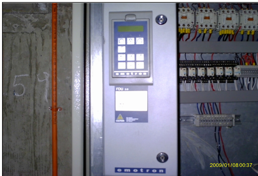
PANEL DE CONTROL CON VARIADOR DE FRECUENCIA
