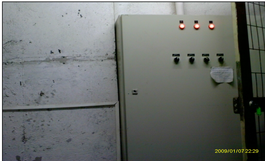
PANEL DE CONTROL CON VARIADOR DE VELOCIDAD
