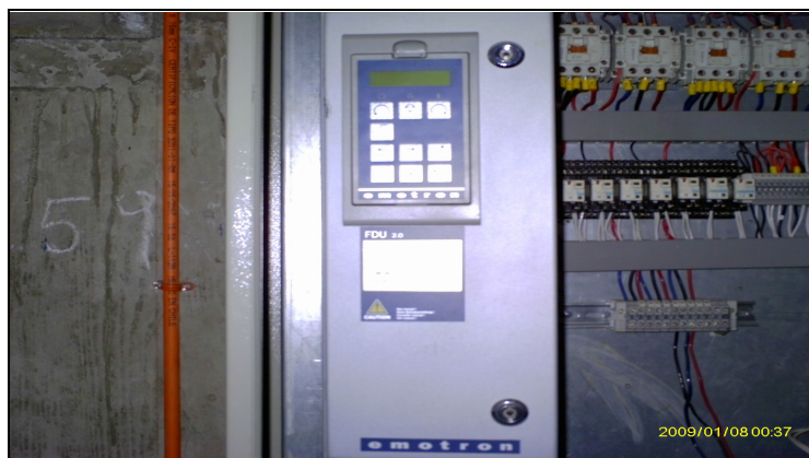
PANEL DE CONTROL CON VARIADOR DE VELOCIDAD
