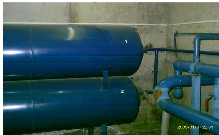
ESTANQUES DEL HIDROPACK
