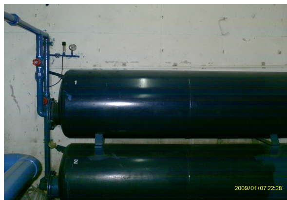
ESTANQUES DEL HIDROPACK
